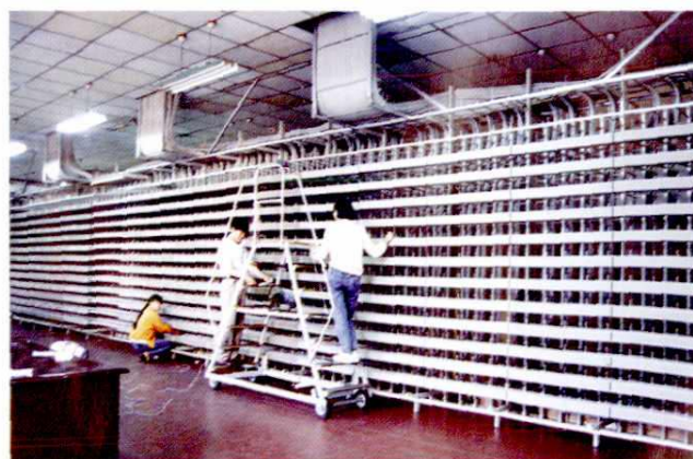
机房市话配线架
