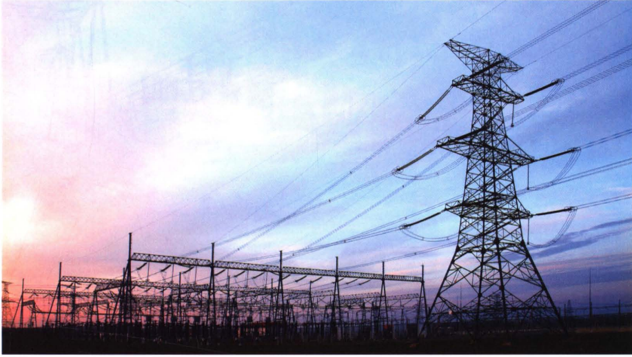
500千伏牡丹变电站
