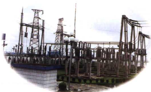
▲ 110 千伏安变电所
