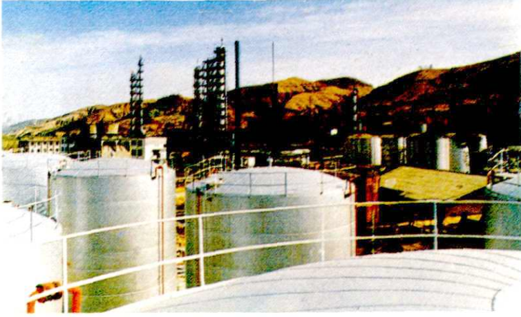
永坪炼油厂的罐区
