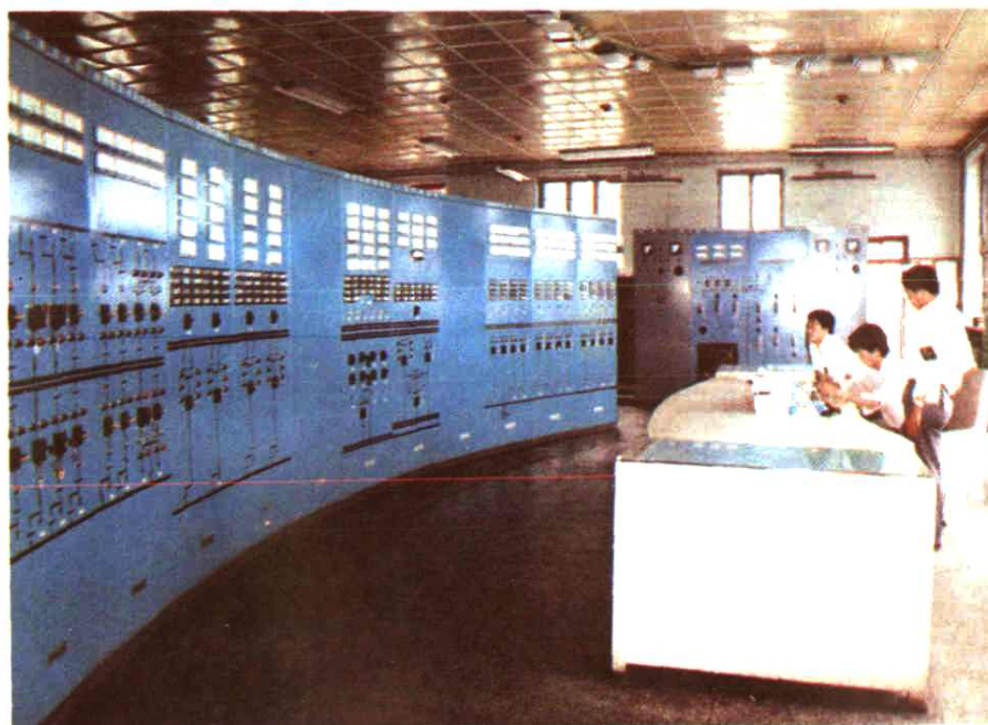
一次变主控室
