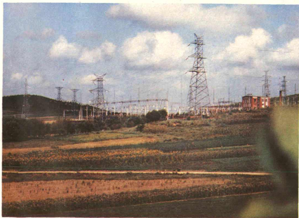
联结鸡、牡、佳电网的佳南一次变电所
