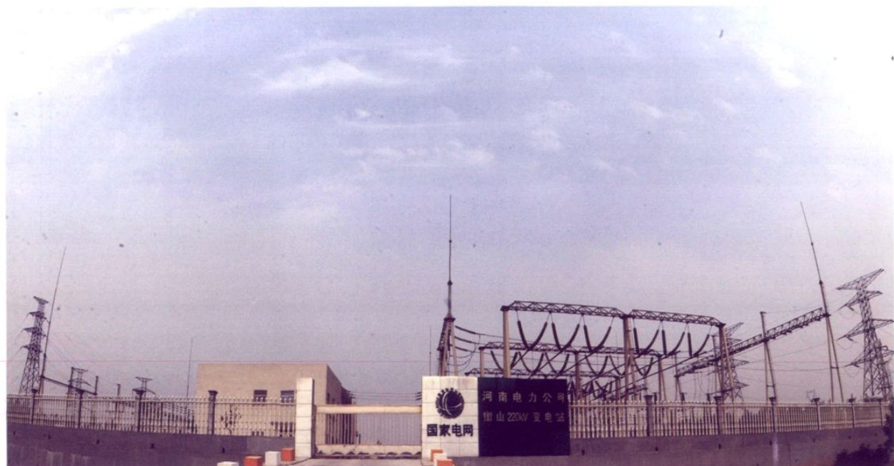
衡山220千伏变电站（2008年12月投运）
