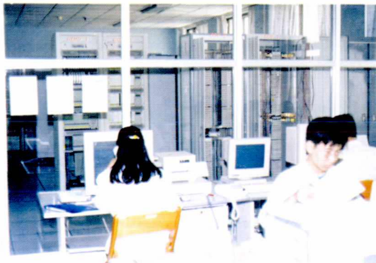
◀数据通信机房及数据网网管中心
