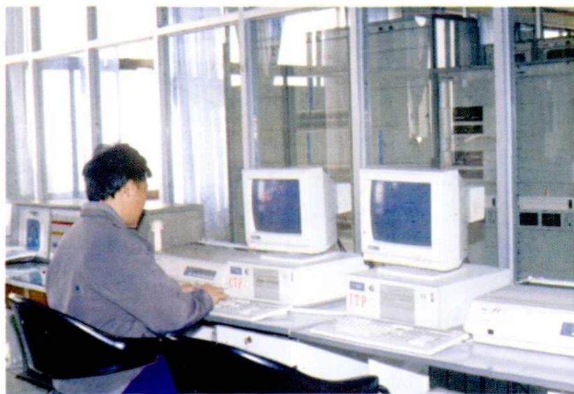
◀自动转报和用户电报交换 “二合一”系统机房
