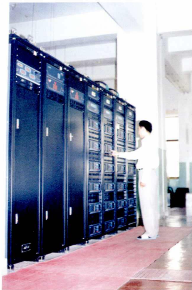
▲枢纽大楼装用的高频开关电源设备
