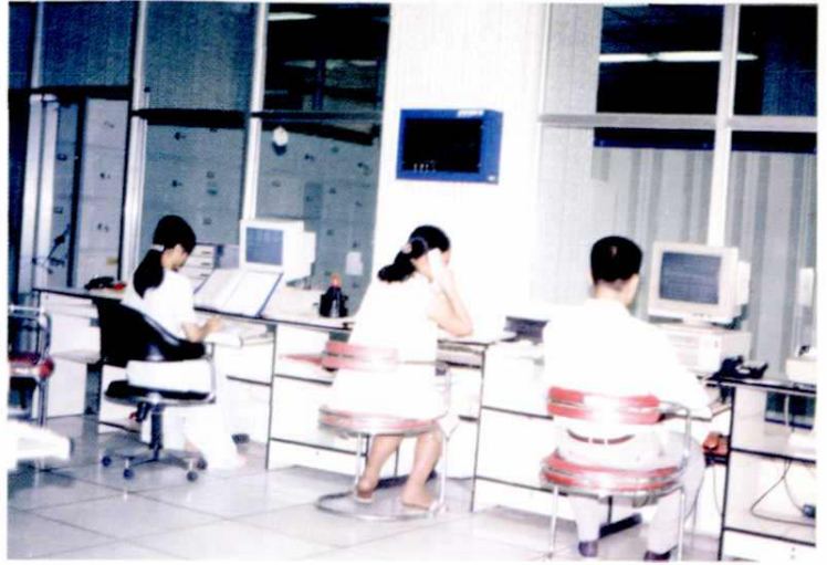
▲电信枢纽大楼长途程控自动电话交换机房
