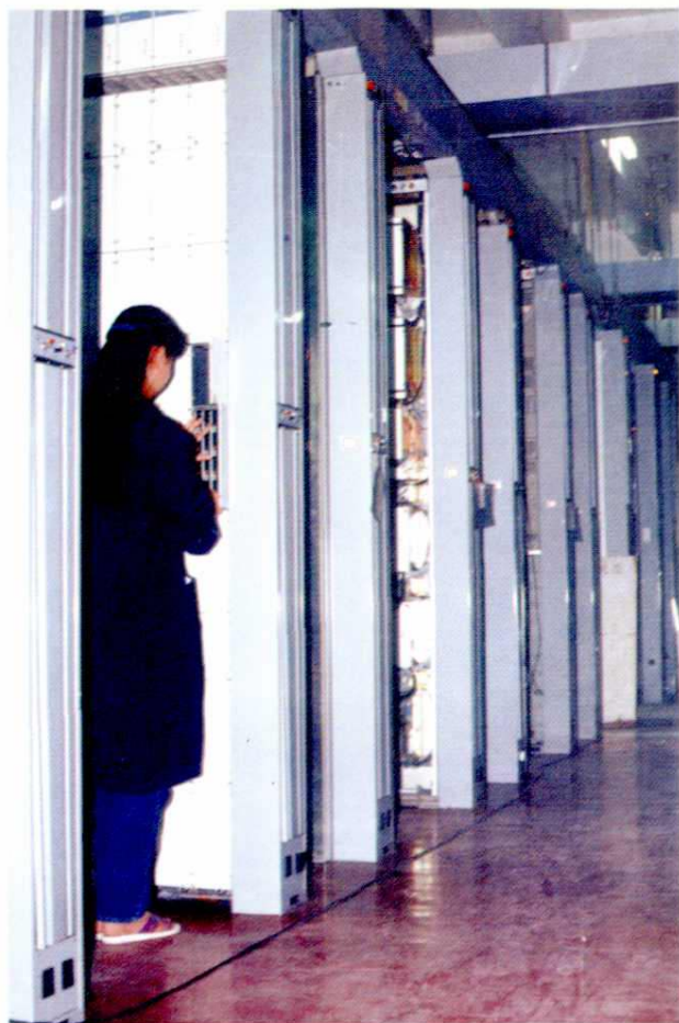
▲枢纽大楼光通信终端设备
