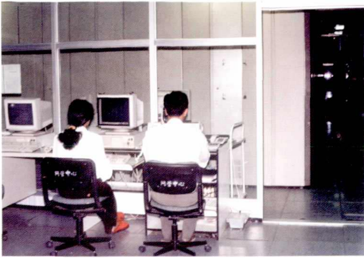
◀ 电信枢纽大楼市话程控自动交换机房
