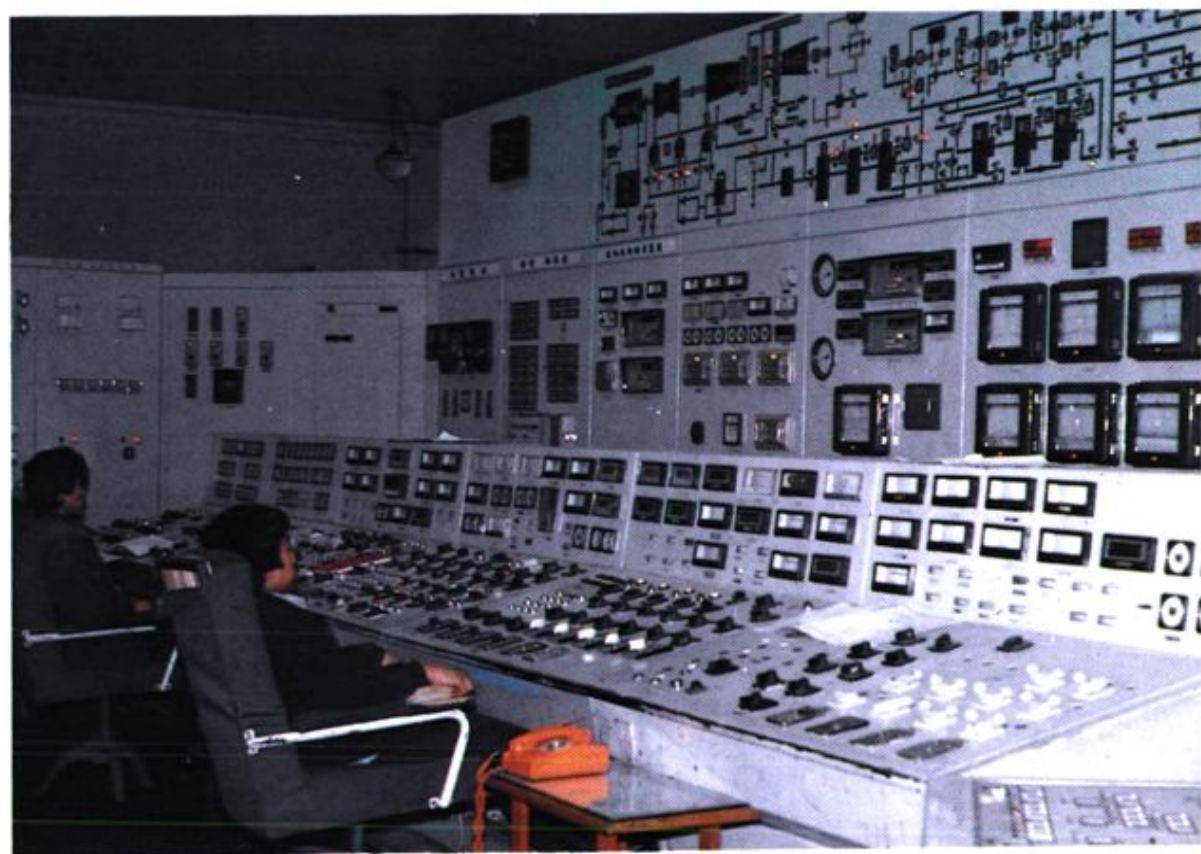
单元集中控制室
