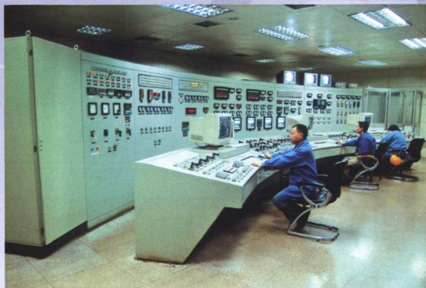
南京热电厂5号 机炉控制室(2004年 3月摄)
