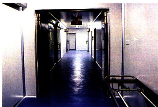
县中医院层流进化手术间
