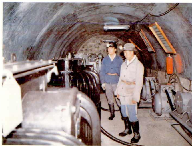
煤矿井下中心配电硐室
