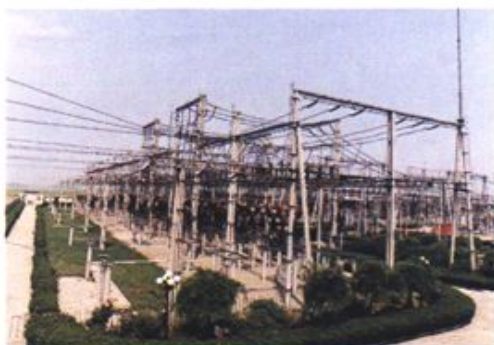
220kV 红庙变电站
