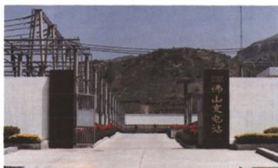
220kV 佛山变电站
