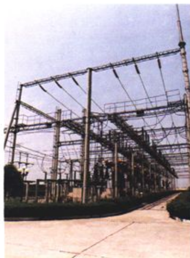
220kV 南流泉变电站
