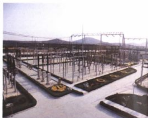
220kV 天平变电站
