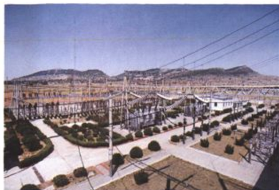
220kV 桃园变电站
