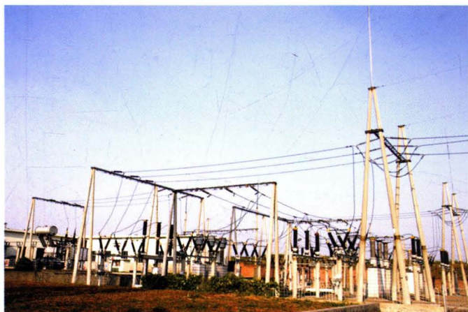
1997年9月5日建成投运的110千伏城南变电站，是公司第一座无人值守变电站。
