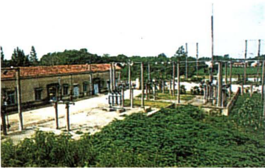
红光 35KV 变电站
