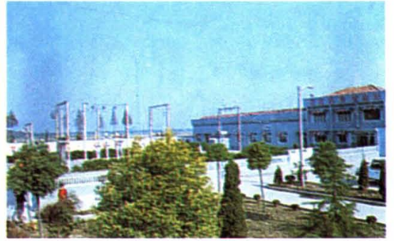
贺富店 35KV 变电站
