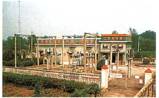
二河 35KV 变电站
