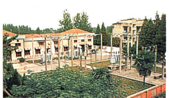
刘隔 35KV 变电站
