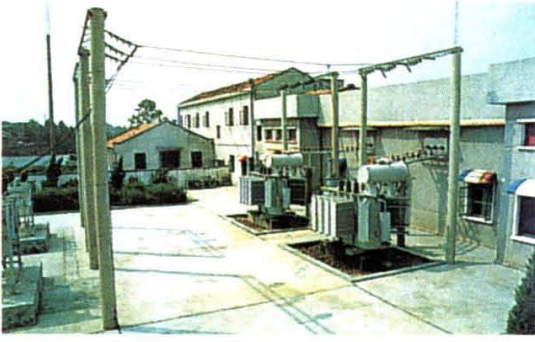
马口 35KV 变电站
