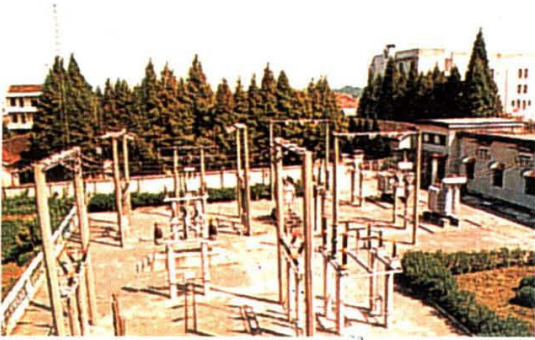
脉旺 35KV 变电站
