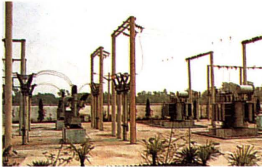
沉湖钢丝绳厂 35KV 变电站
