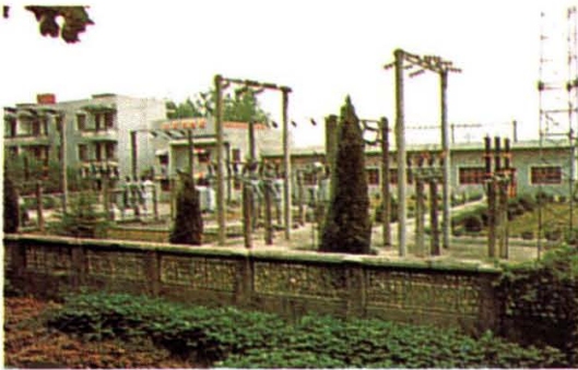
红星 35KV 变电站
