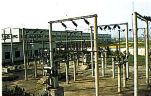
脉旺钢管厂 35KV 变电站
