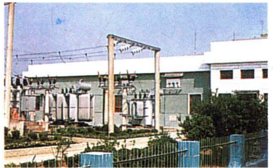
新堰 35KV 变电站
