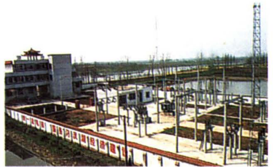
沅汉 35KV 变电站
