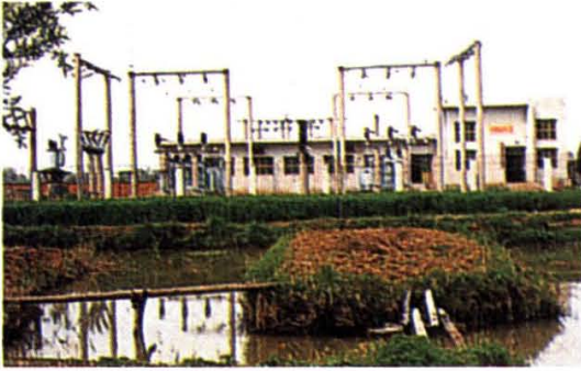
三龙 35KV 变电站
