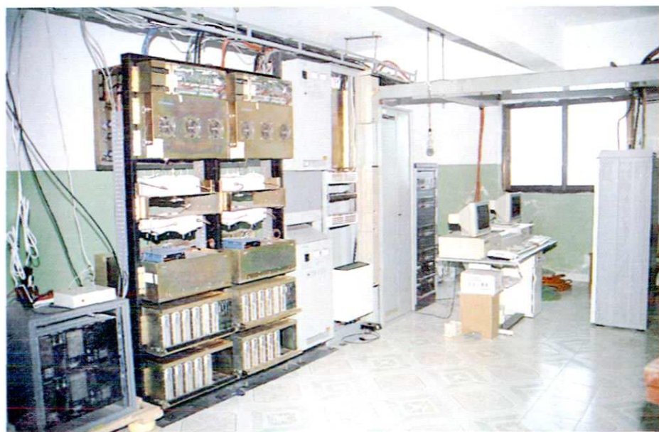
移动通信机房
