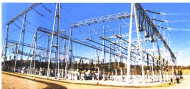
兰坪铅锌矿冶炼厂中心变电站
