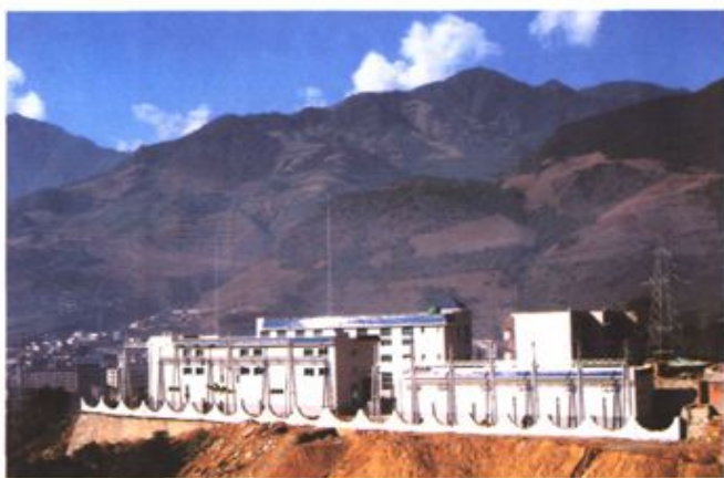
六库中心变电站
