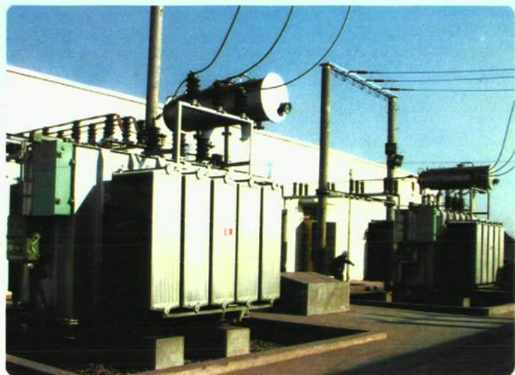
新峰35千伏变电站外景
