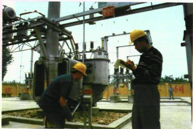
1999年6月12日，我市第一座35千伏无人值班变电站——赵店35千伏变电站投运
