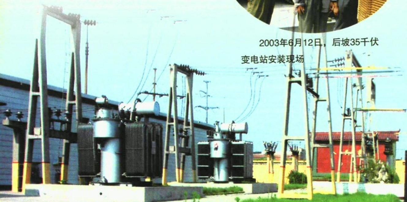
高坡35千伏变电站局部
