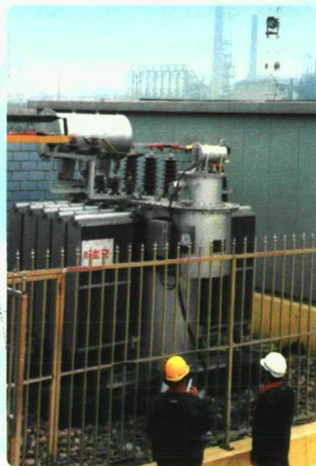
东河湾35千伏箱式变电站外景
