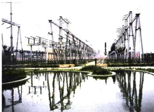
西官庄 220KV 变电站
