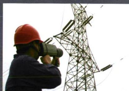
2005年，检修人员对导线接点进行红外线测温
