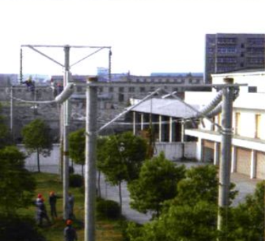
2004年，新建110~220千伏模拟训练场
