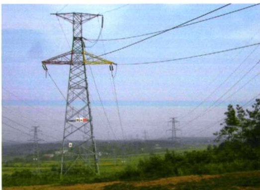
220千伏双（河）鄂（中）线
