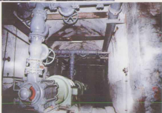
煤矿井下水泵房
