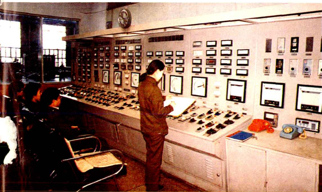
◁ 10万机组控制室
