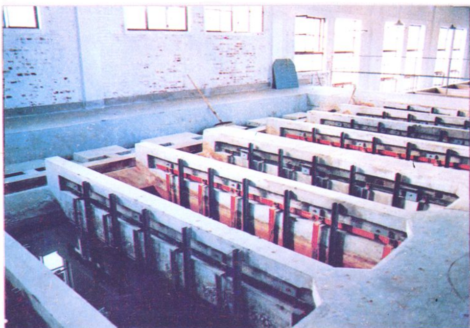
新疆第二毛纺厂污水处理车间
