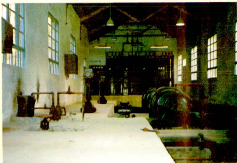
▶ 福地灌区西村抽水工程二级站机房
