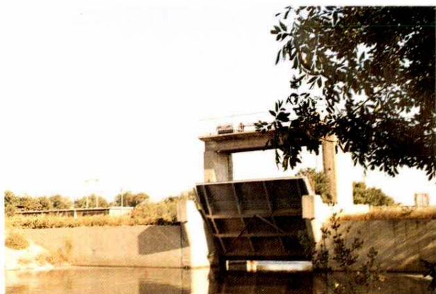
津港河上的节制闸
