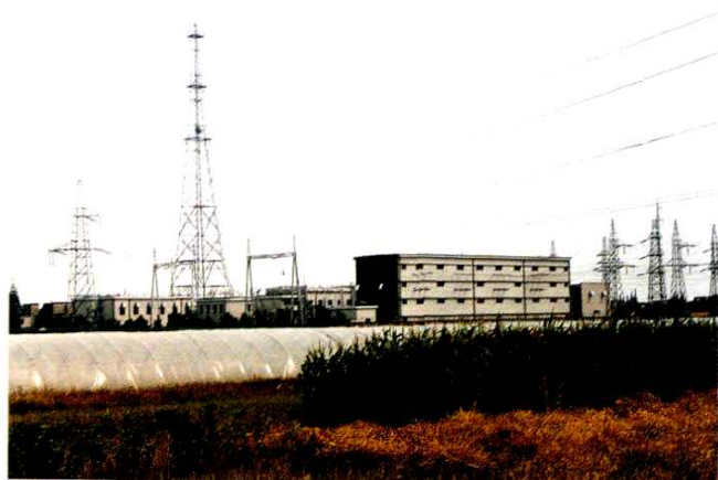
位于周埠村的22万伏变电站。
