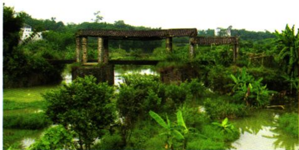
文昌桥 位于郁南县建城镇西宁公园内，又名官桥。始建于明万历四年（1576年），后因两度被毁而改建于天后庙前，清康熙九年（1670年）重修。将原露天桥改为梁架式屋桥，长16米，宽2.4米，高5米，桥面铺置木板，并设有风雨亭，现桥损坏严重
