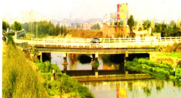
1993年11月建成通车的省道S276腰那线洗河桥，桥长94.5米，桥面宽13米
