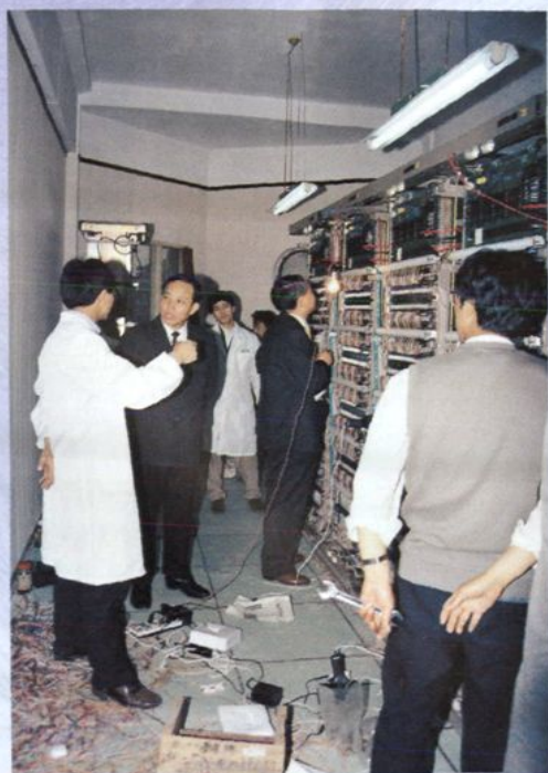
1994年4月22日，邮电部副部长林金泉（左二）视察溪口邮电支局正在安装数字程控机的机房和营业场所
