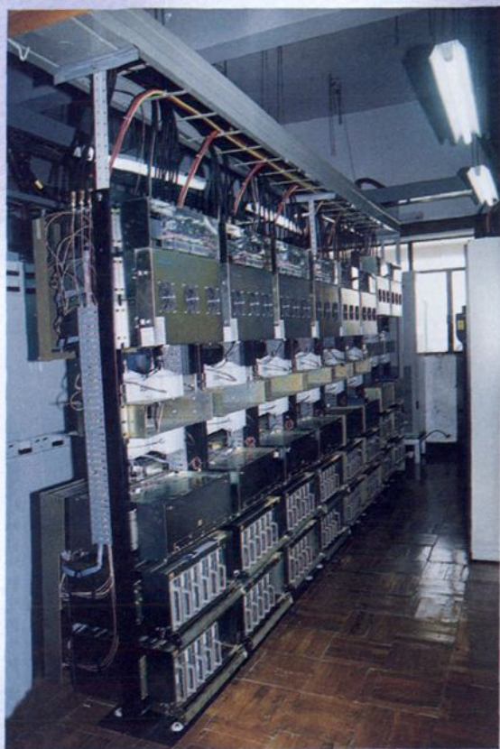
无线通信机房
