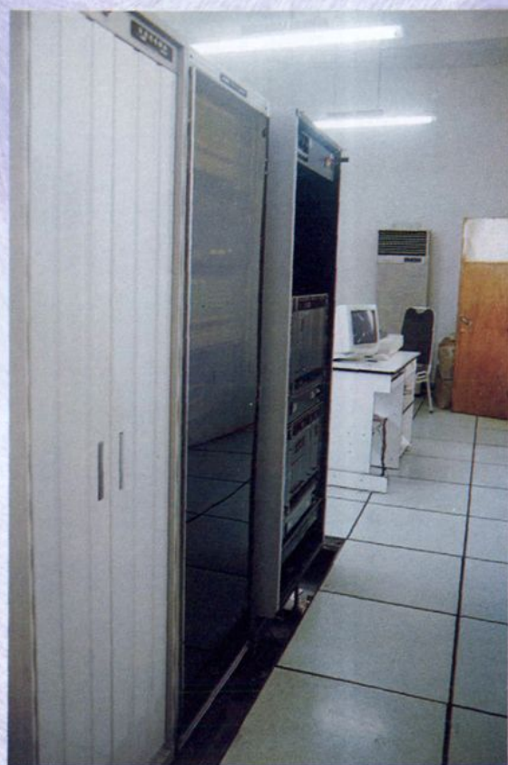
数据通信机房
