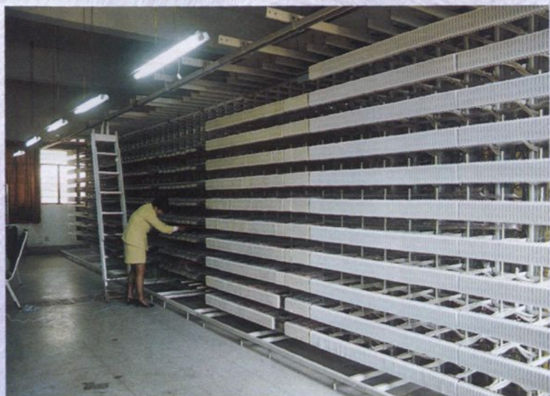
市话总配线室
