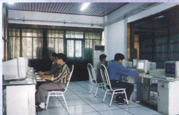
程控机房控制室
