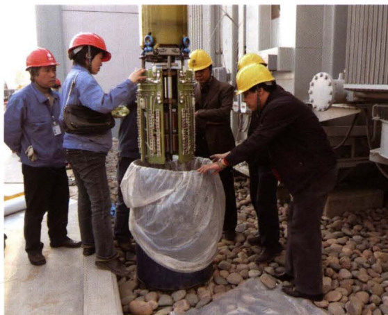
首套国产500千伏有载调压开关检查
