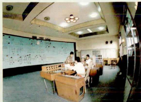
赣东北供电局地区调度控制室
