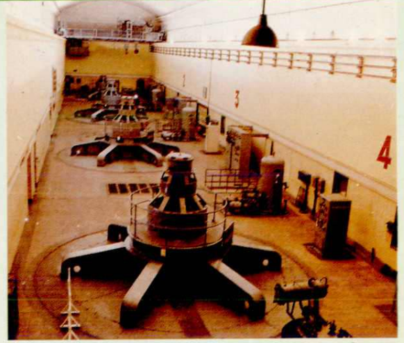
上犹江水电厂的坝内式厂房 (王诚忠摄)
