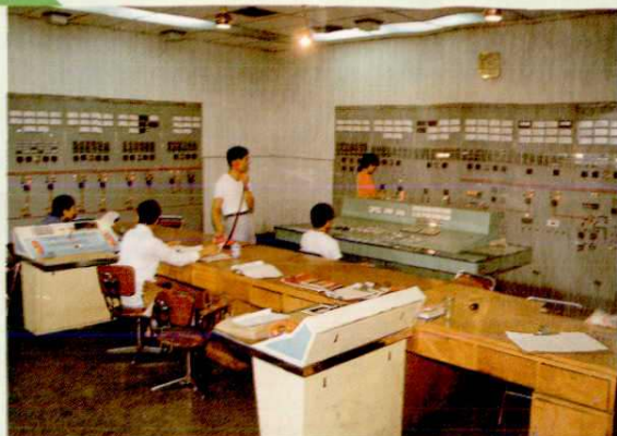
南昌电厂主控制室
