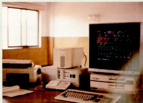
(郝伯泉摄) 彭泽县供电局电力调度运动装置
