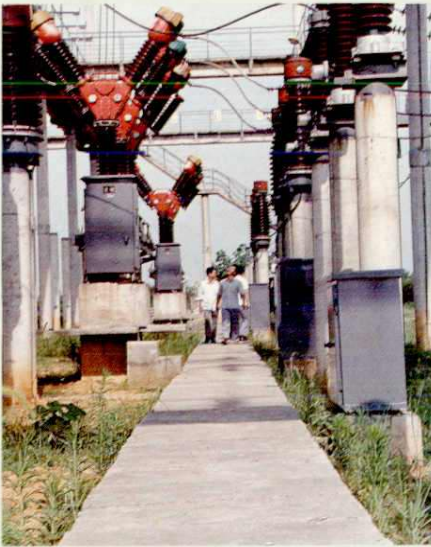
萍乡供电局工人正在巡视跑马坪 220 千伏 变电站设备
