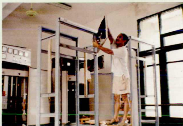
南昌供电局光明电力设备厂生产、安装 GGD 低压配电盘 (杜宏志摄)
