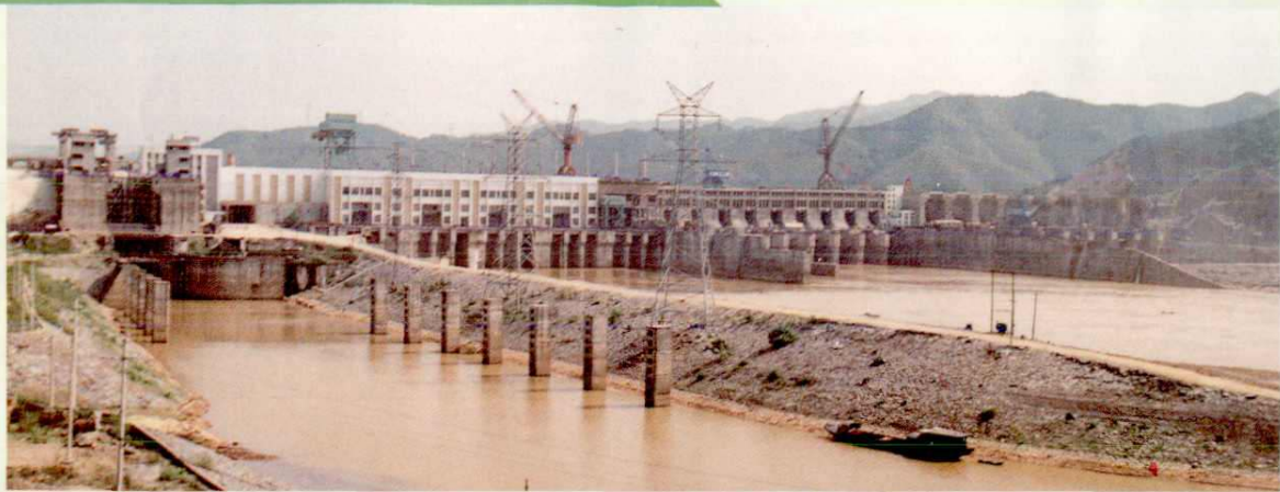
正在建设中的国家重点工程——万安水电站全景,装机 4 \times 10 万千瓦
