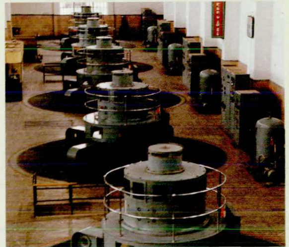
洪门水电厂的5台机组正在稳定运行
