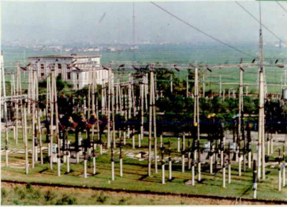
赣西供电局 220 千伏珠珊枢纽变电站
