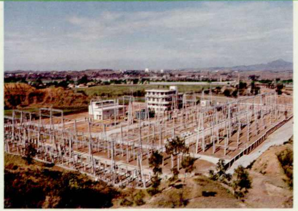
赣南老区第一座 220 千伏变电站——虎岗变电站(熊义诏摄)
