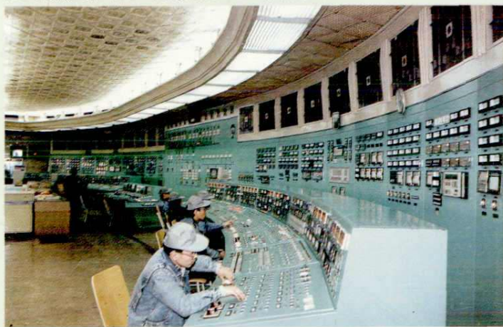
九江火力发电厂主控室
