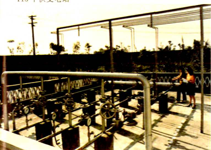
天然气配气站
