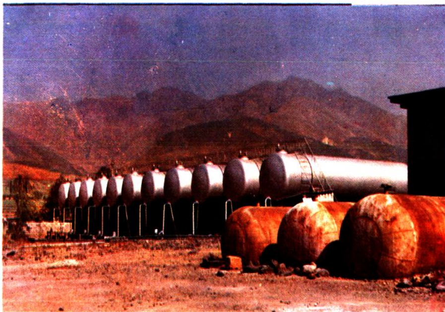
9. 沙坝石油库部份储油罐
