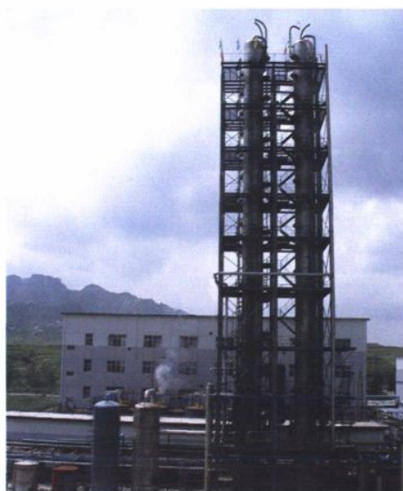
金治纳米硝酸吸收塔
