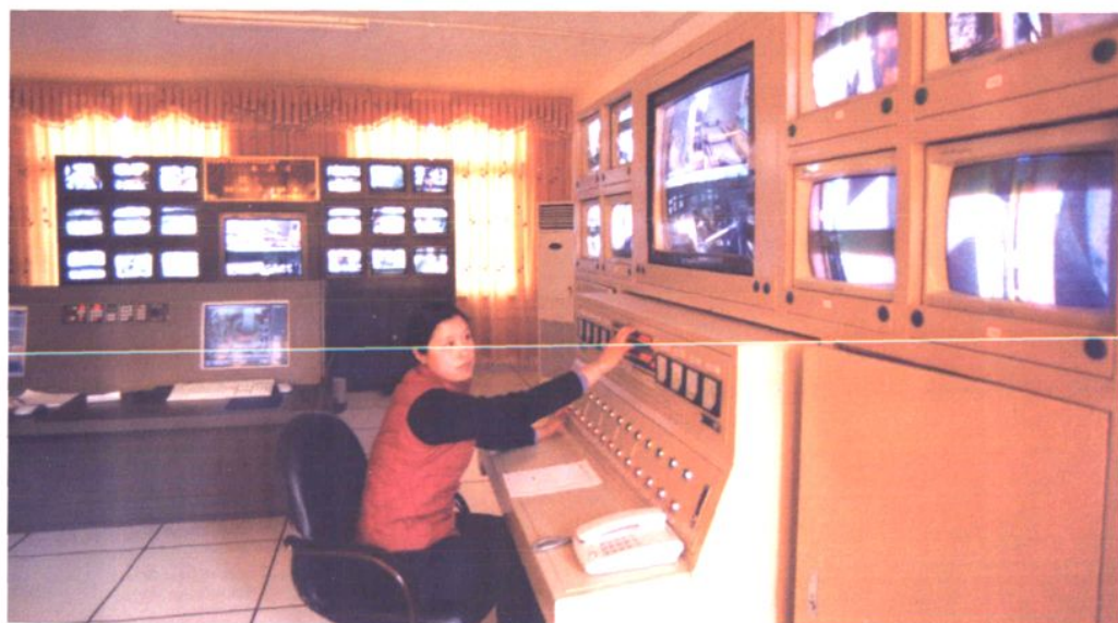
选矿中央控制室电视监控系统
