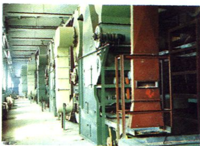
打叶复烤车间 生产线设备一角。
