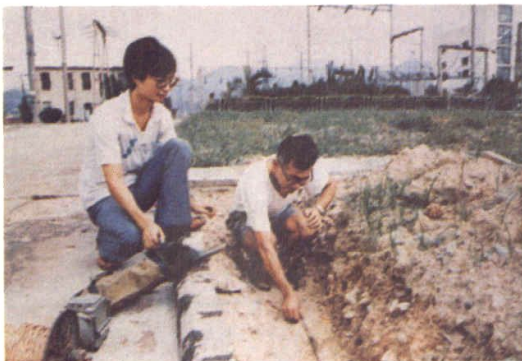
对重要厂、站接地网进行普查， 查出危害安全运行隐患
