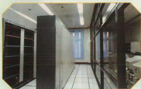
装备优良的程控机房
