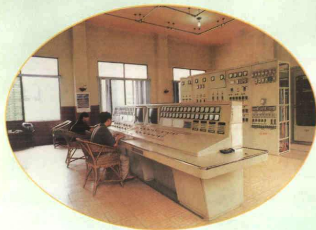
城区110千伏变电站中控室
