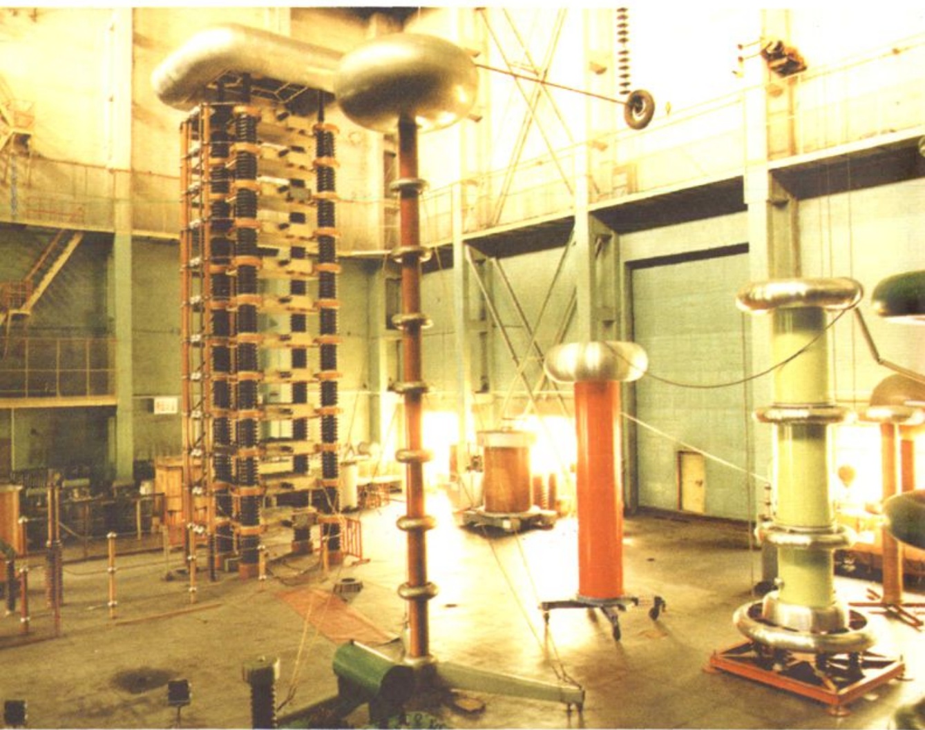
高(电)压试验装置
