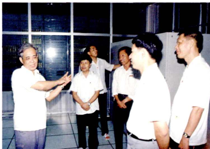
1992年6月23日,广西邮电管理局局长许振环(左一)视察玉林程控机房
