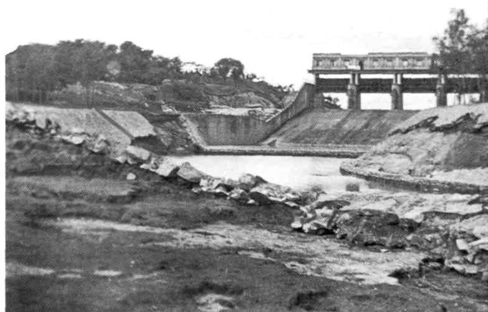
板桥水库溢洪道被冲毁
