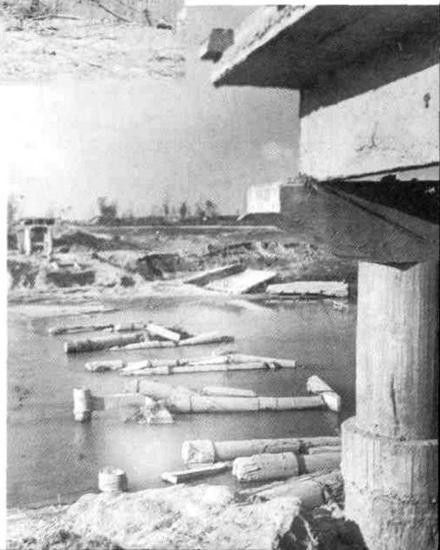
遂平县南关汝河公路大桥被冲毁
