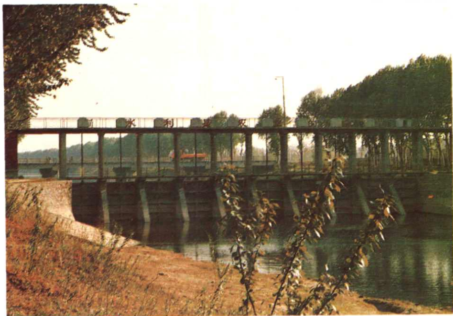
◀ 马颊河节制闸
