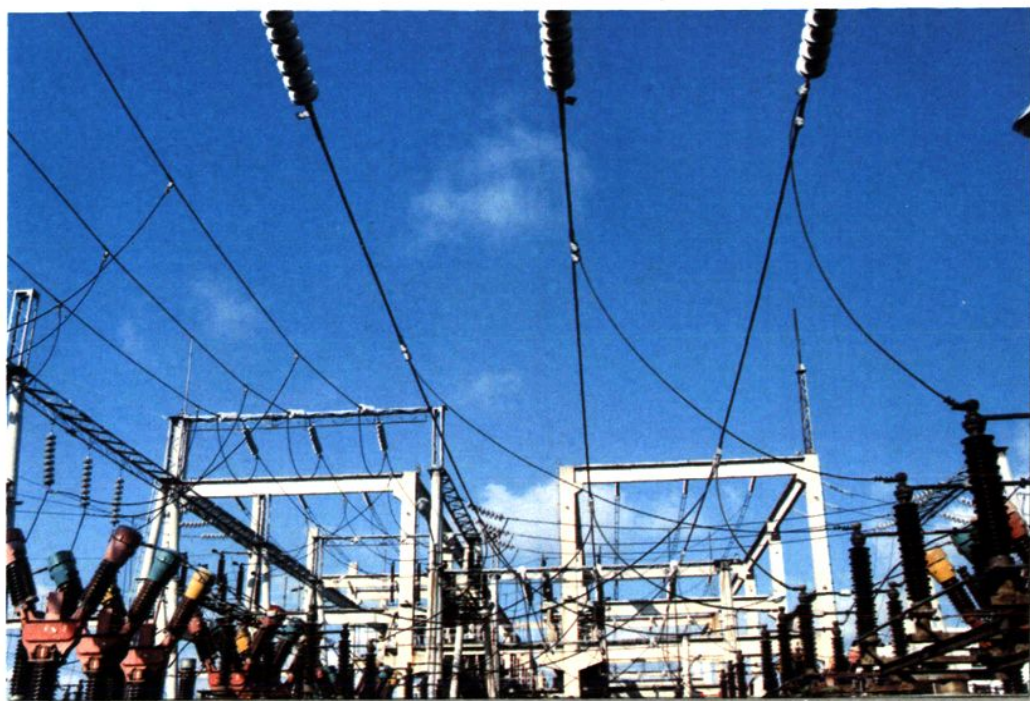
110KV、220KV 变电枢纽
