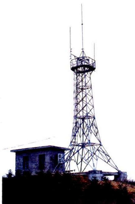
无线接入机房
