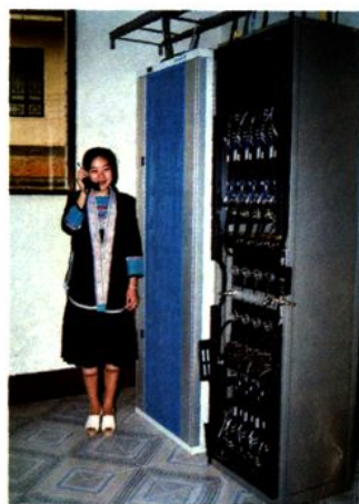
移动通信机房
