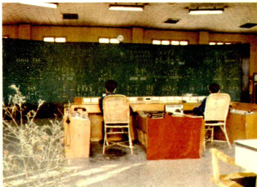
邵阳电业局调度室内景。
