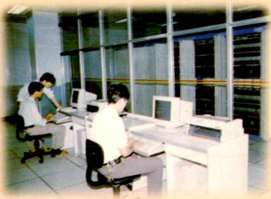
孝感市邮电局程控电话于1992年8月份开通，图为工程技术人员在宽敞、整洁的程控机房工作时情景。
