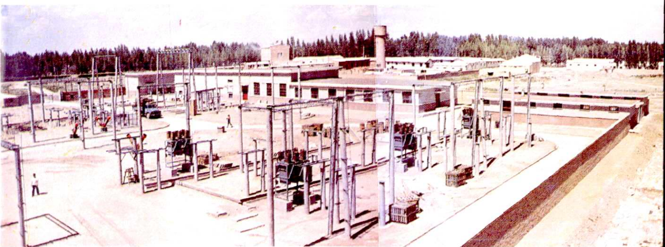
大庄子110千伏变电所
