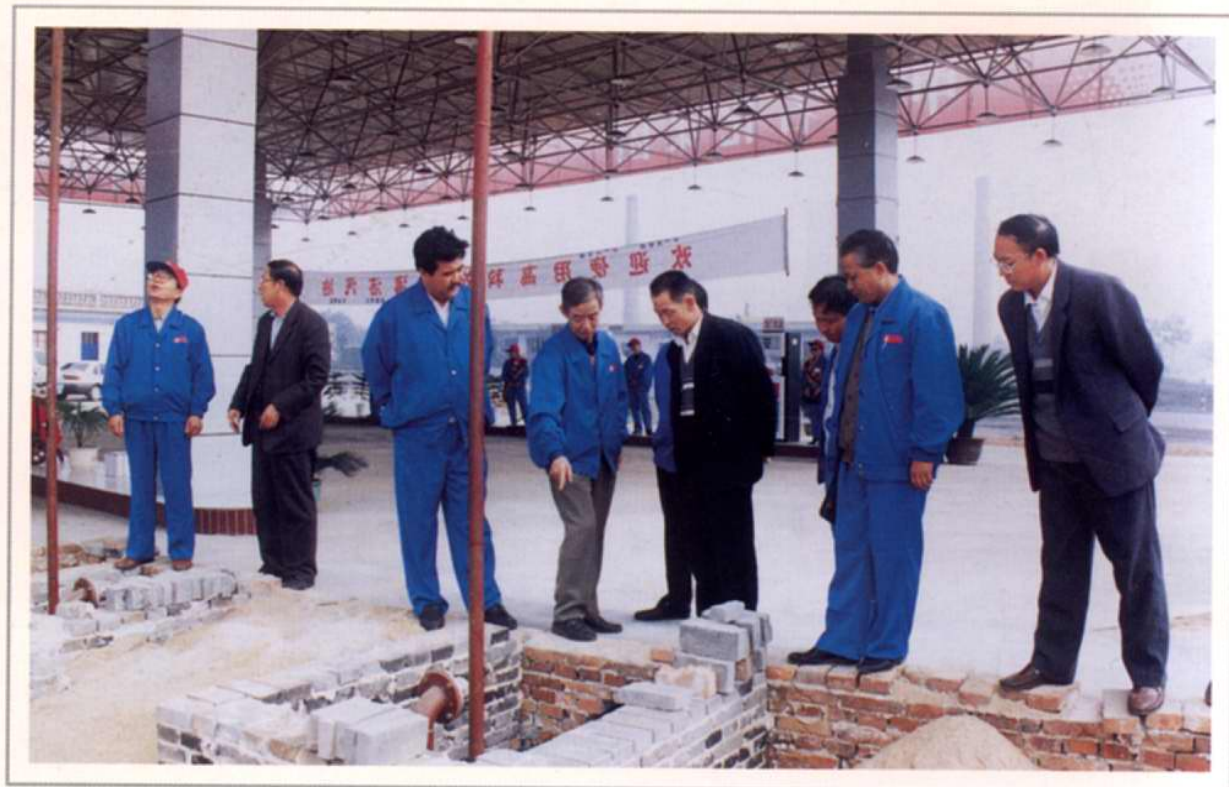
张开印副经理与公司党支部副书记高有堂检查验收施工质量
