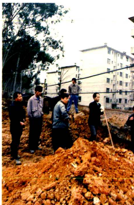
长途光缆通信线路被施工单位挖断现场。
