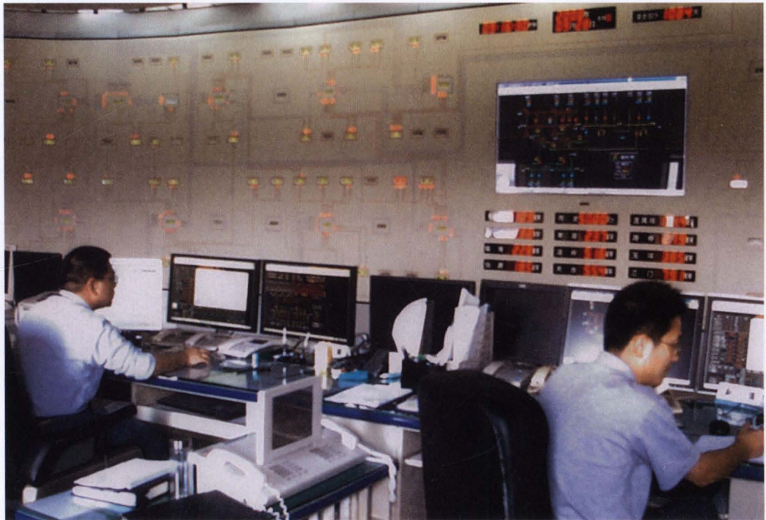
◇台州电力调度室
