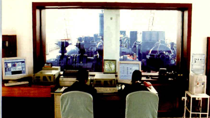
监测机泵运行
