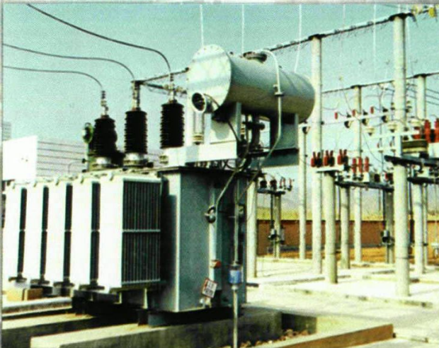
朝阳农电系统第一台10000千伏安有载调压变压器
