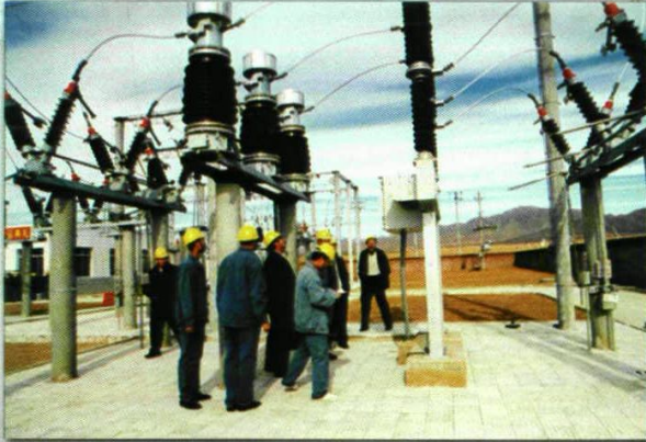
变电运行人员进行现场培训
