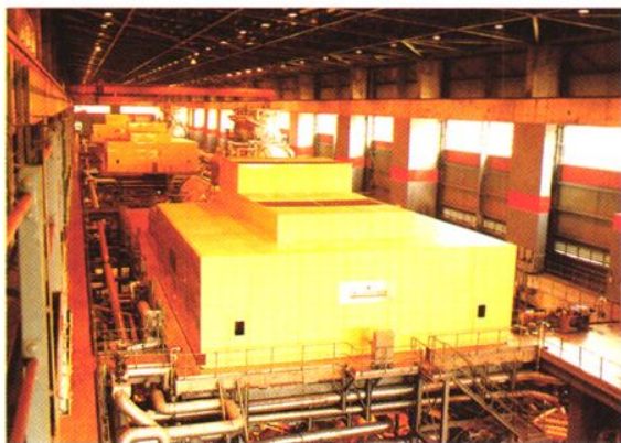
沙角C电厂3X66万KW全套进口机组
