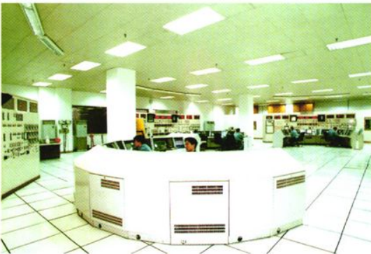
沙角 C 电厂66万KW万机组集控室
