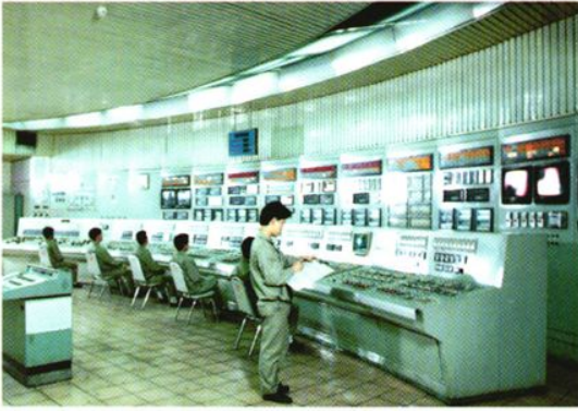
沙角 A 电厂30万KW万机组集控室
